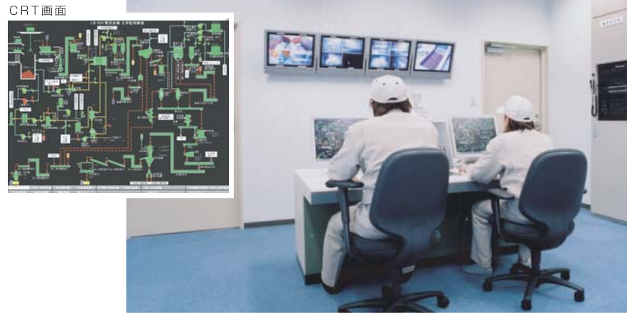
中央制御室 常時、受入基準に適したRDFを監視し、施設全体の運転、制御を行います。
