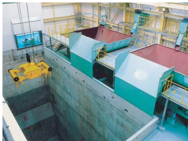
ごみピット・クレーン ごみを貯留して均一に攪拌し、ホッパに供給します。
