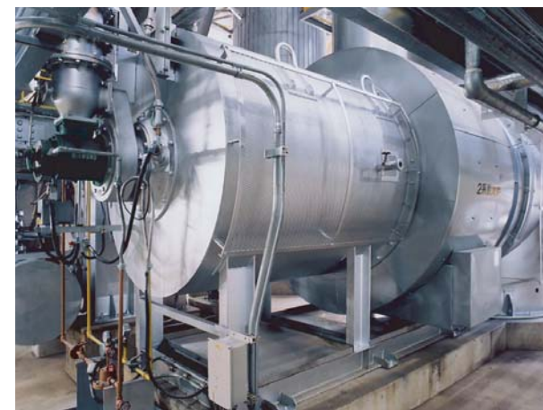
脱臭炉 乾燥機排ガスの臭気を消します。
